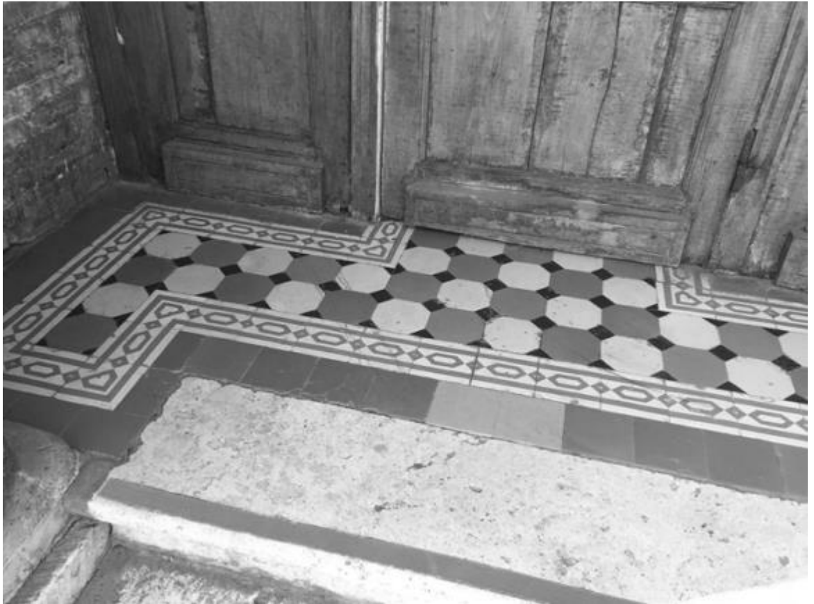
Фото 15. Объект культурного наследия регионального значения «Здание, в котором находилась детская коммуна, которую в 1925 году посетила Н.К. Крупская», Ставропольский край, г. Пятигорск, ул. Буачидзе, 7 (фактический адресу: ул. Буачидзе, 5). Отделка крыльца главного входа.
