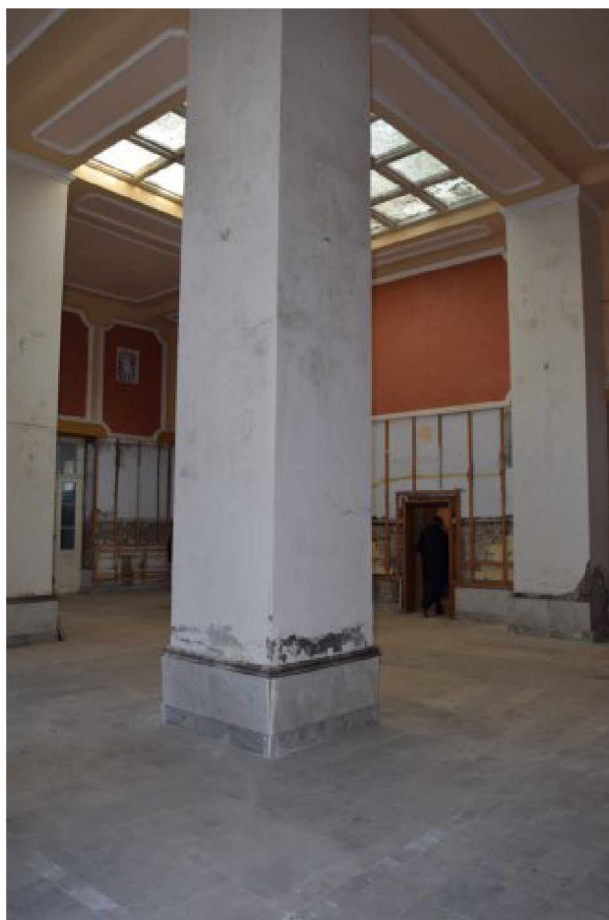
Фото 21-22. Объект культурного наследия федерального значения «Здание Лермонтовских ванн», 1831 год, расположен по адресу: Ставропольский край, г. Пятигорск, просп. Кирова, д. 21. Фрагмент интерьера: мраморное покрытие пола, квадратные колонны (помещение № 65).
