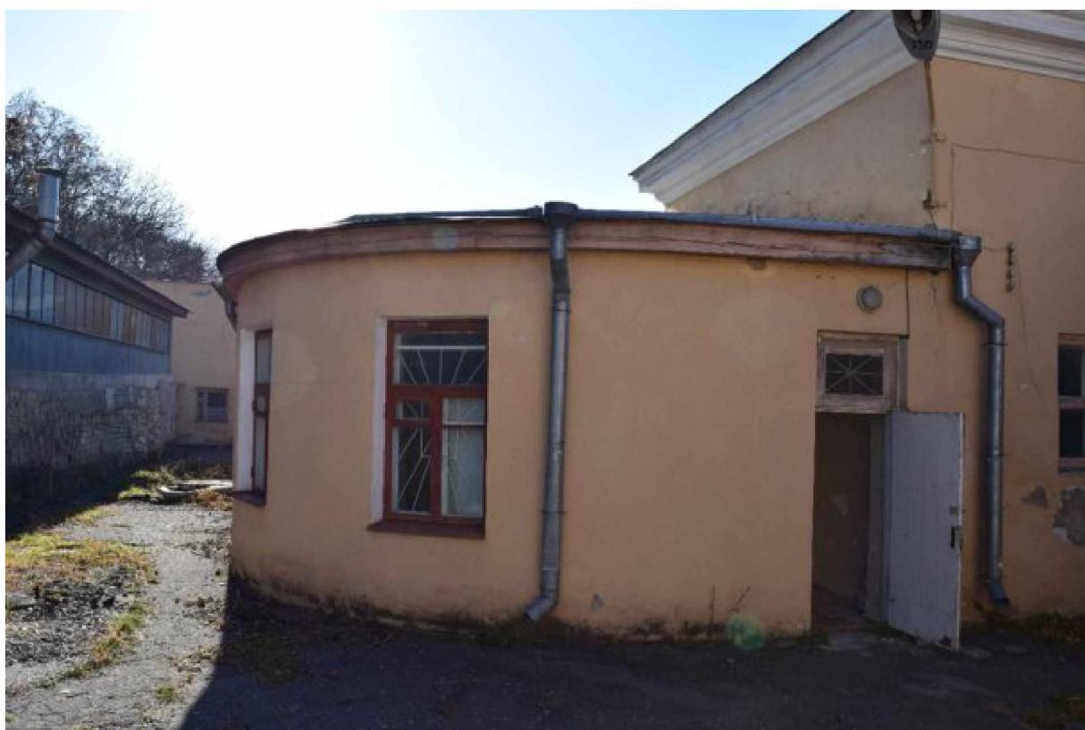
Фото 12-13. Объект культурного наследия регионального значения «Здание Лермонтовских ванн (бывш. Николаевские)», 1831 год, расположен по адресу: Ставропольский край, г. Пятигорск, просп. Кирова, д. 23. Дворовые фасады боковых объемов памятника.
