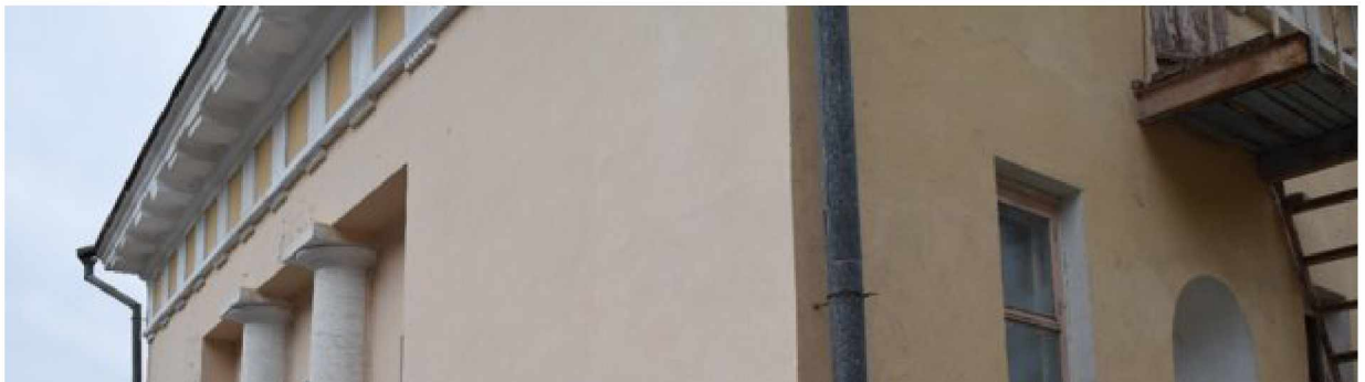
Фото 6-7. Объект культурного наследия регионального значения «Здание Лермонтовских ванн (бывш. Николаевские)», 1831 год, расположен по адресу: Ставропольский край, г. Пятигорск, просп. Кирова, д. 23. Фрагменты северной части памятника.
